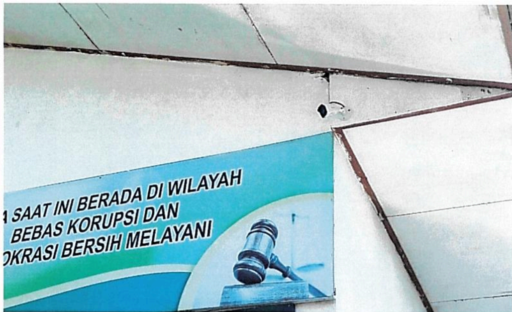
CCTV di Ruang PTSP Kantor PA. Negara
