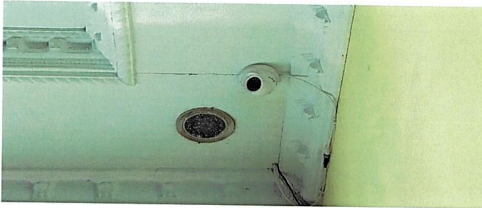
CCTV di Ruang Sidang PA. Negara
